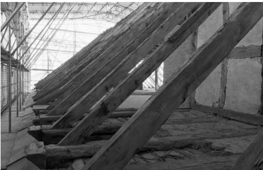
Dank der Einrüstung kann bei jedem Wetter am Dachstuhl gearbeitet werden Fotos: Stiftung Preußische Schlösser und Gärten Berlin-Brandenburg
