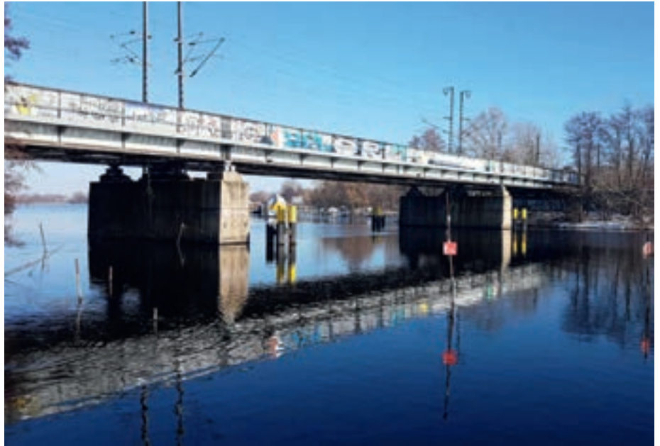
Neben der Bahnbrücke über den Großen Zernsee soll die neue Fuß- und Radwegbrücke entstehen. Foto: Landeshauptstadt Potsdam/Martina Woiwode
